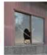
窓が割れた管理不全空家
