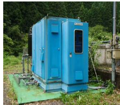
膜ろ過設備（下根来簡水）
