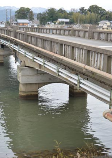
老朽化した西津橋
